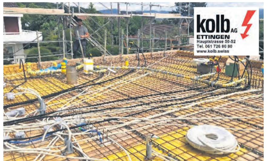
Neubau mit unseren Installationsrohren.
